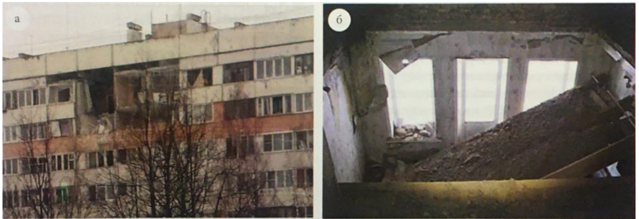
Рис. 2. Обвалення конструкцій внаслідок руйнування закладних деталей: а – обвалення стінових панелей; б – обвалення плити перекриття.
